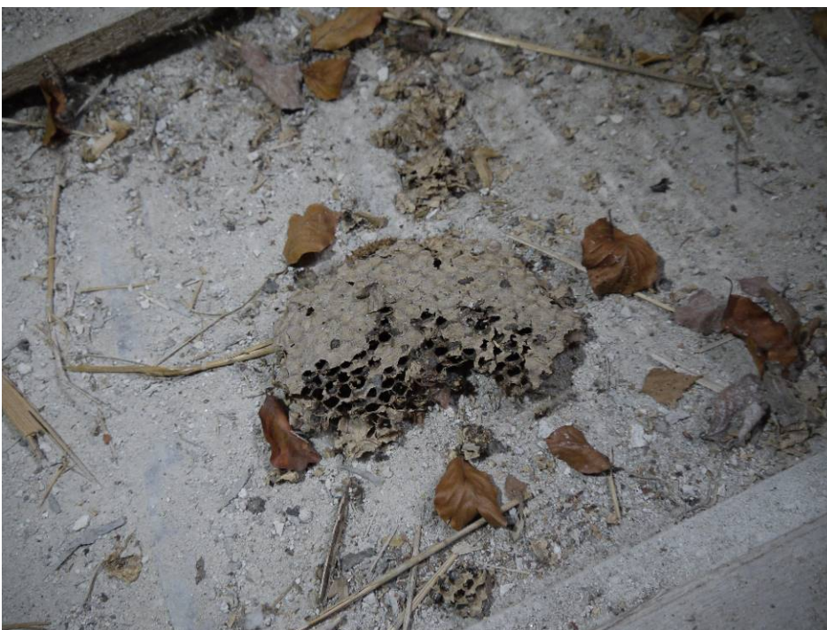
Abb. 6: Hornissennest im Dachgeschoss.
