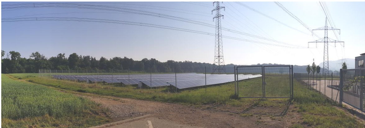
Abb.: bestehende Freiflächen PV-Anlage
