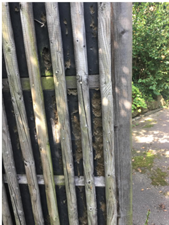
Steinwolldämmplatte und Glasvlies vermutlich durch Vögel beschädigt → eher rein optischer Mangel
